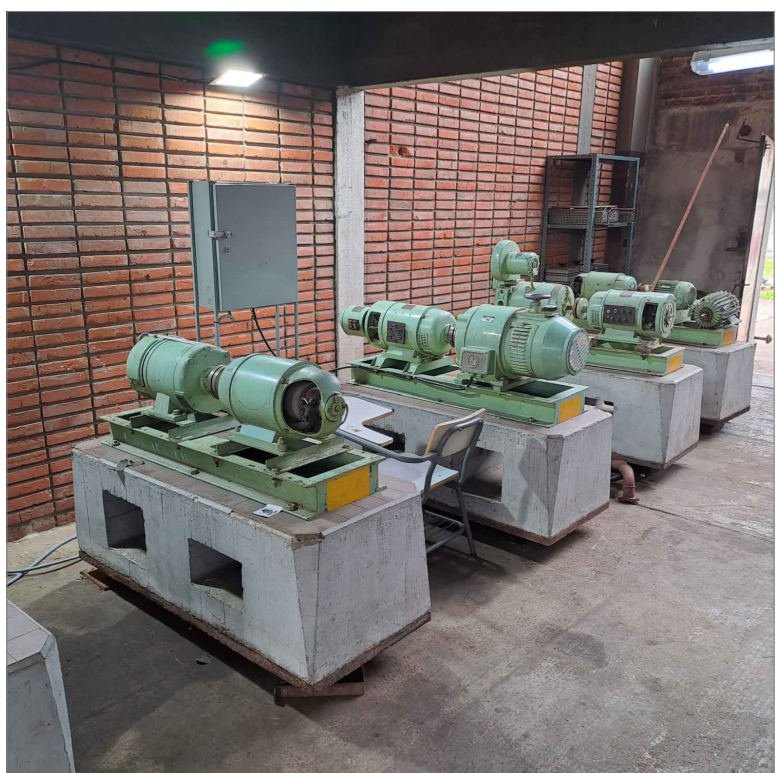
GENERADORES A REUBICAR S/RECAUDOS
